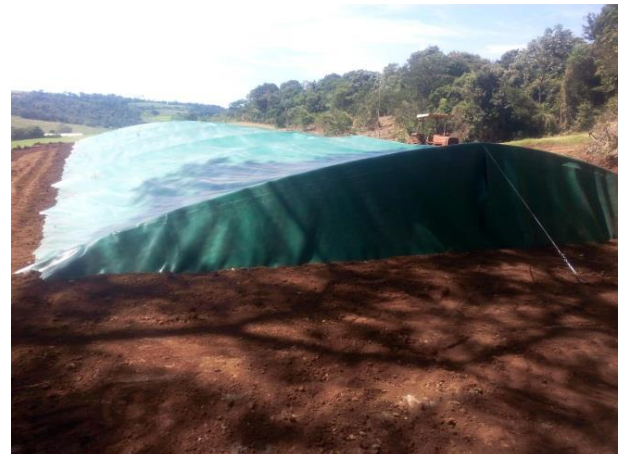
Figura 3. Cisterna finalizada, com cobertura. Pode-se ainda, deixá-la aberta, sem necessidade de armação e cobertura, desde que realizada o controle de vetores com o uso do cloro, por exemplo.
